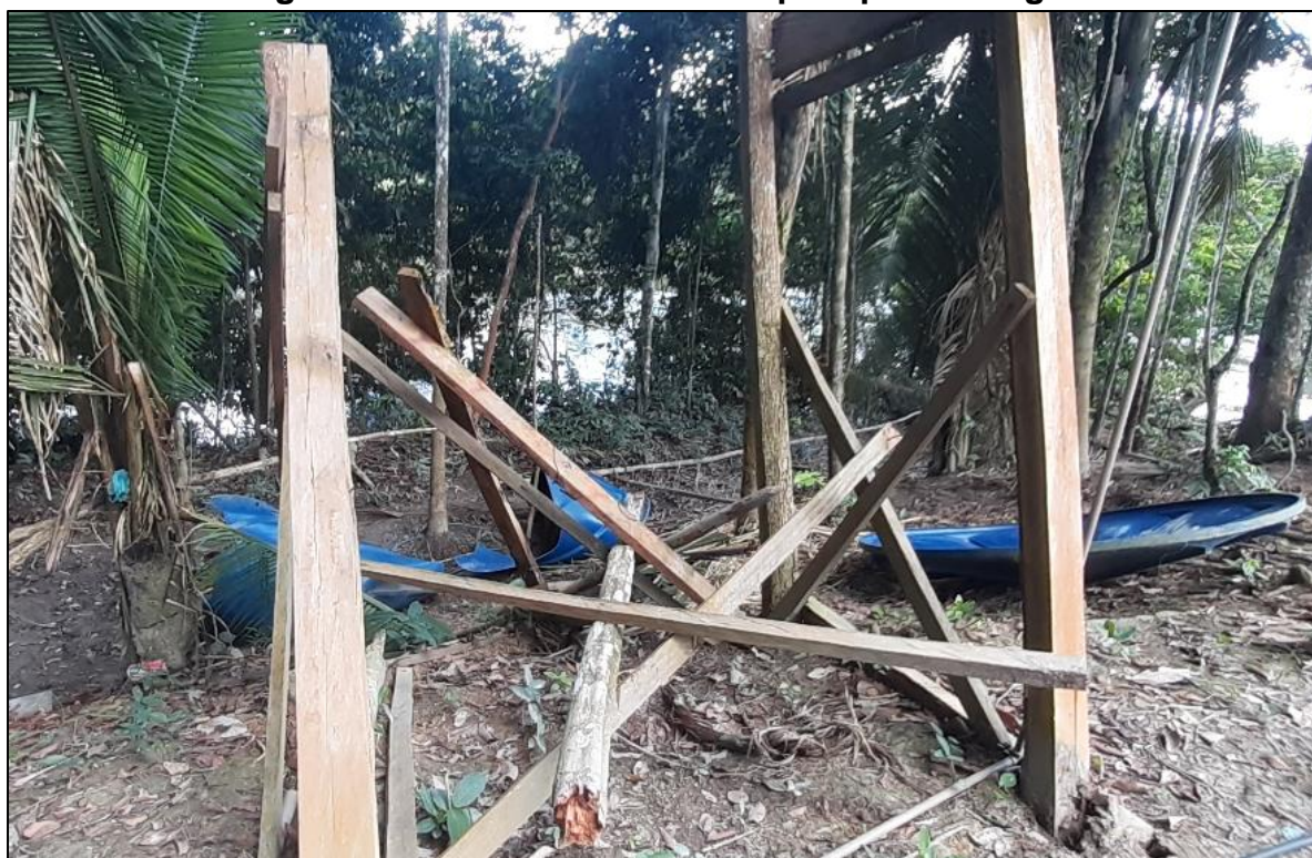
Figura 17 – Estrutura destruída pelo peso da água
