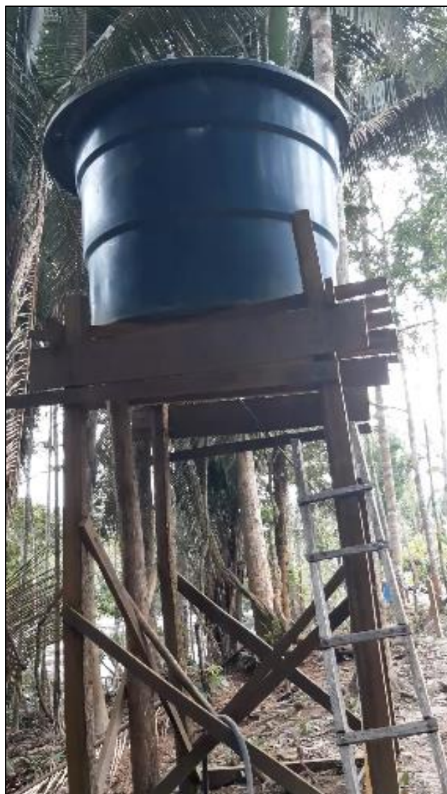
Figura 15 – Caixa d'água de 5 mil litros que abastecia a comunidade
