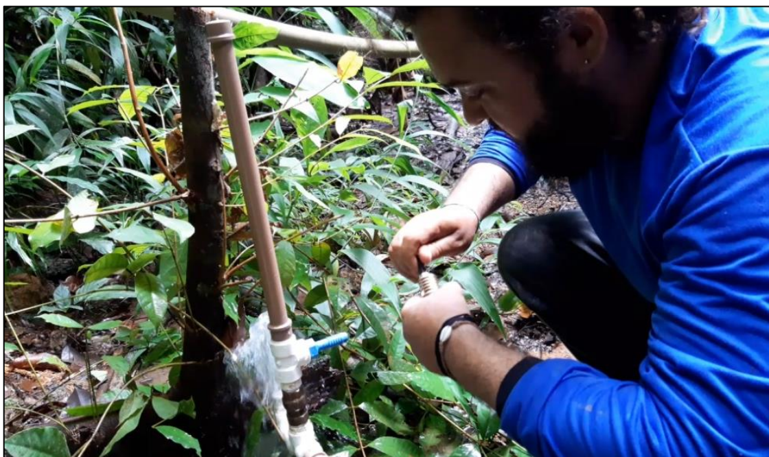
Figura 16 – Primeiras instalações do carneiro hidráulico
